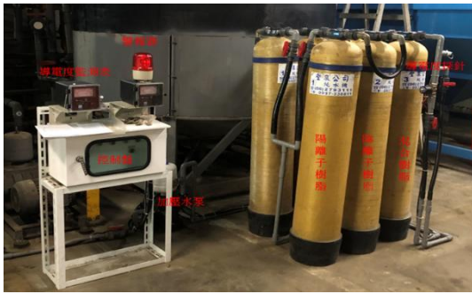
109~110 年節水專案：缺水期間緊急應變將製程放流水以離子交換樹脂再生設備處理後回用於冷卻水
