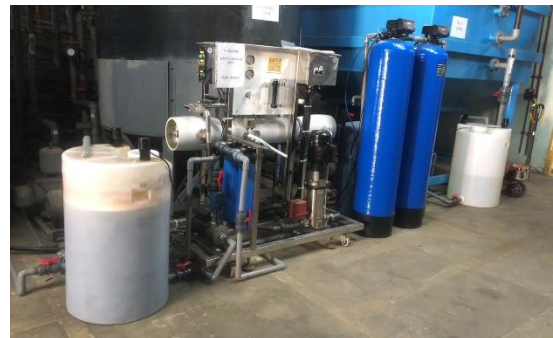
111~112 年節水專案：設置 RO 逆滲透再生設備，計畫常態性將製程放流水再生後回用於冷卻水
