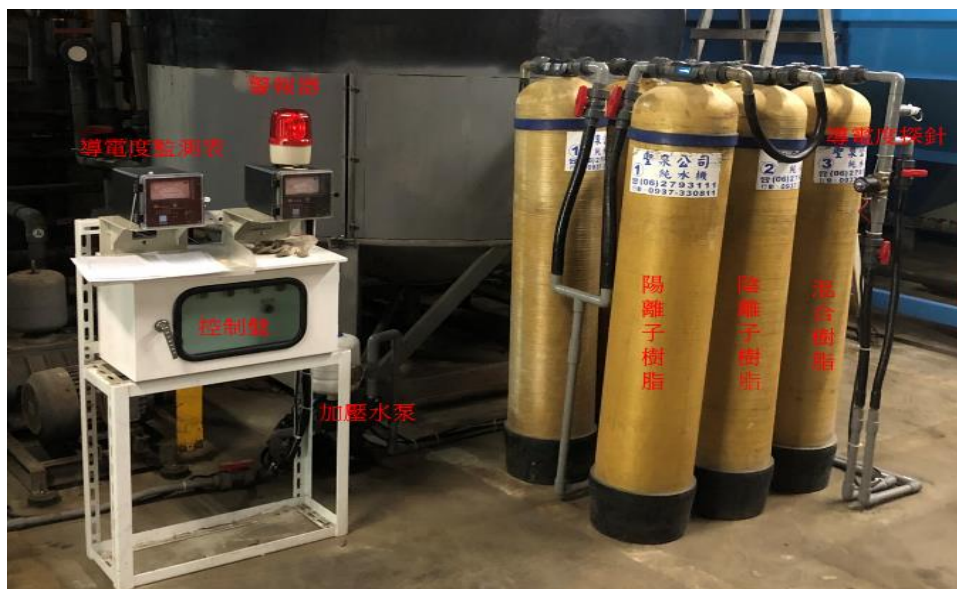
放流水以離子交換樹脂再生設備(回用於冷卻水)
