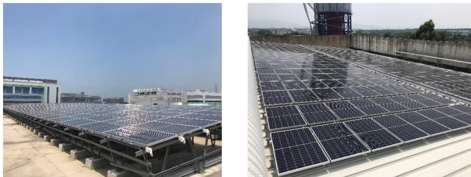
屋頂太陽能發電設備照片
